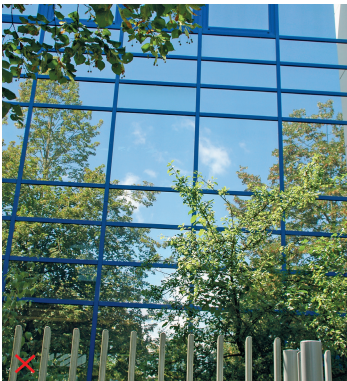
Illustration 11: Un vitrage pare-soleil très réfléchissant et des arbres – un cocktail léthal pour les oiseaux. © Archives de la Station ornithologique suisse
